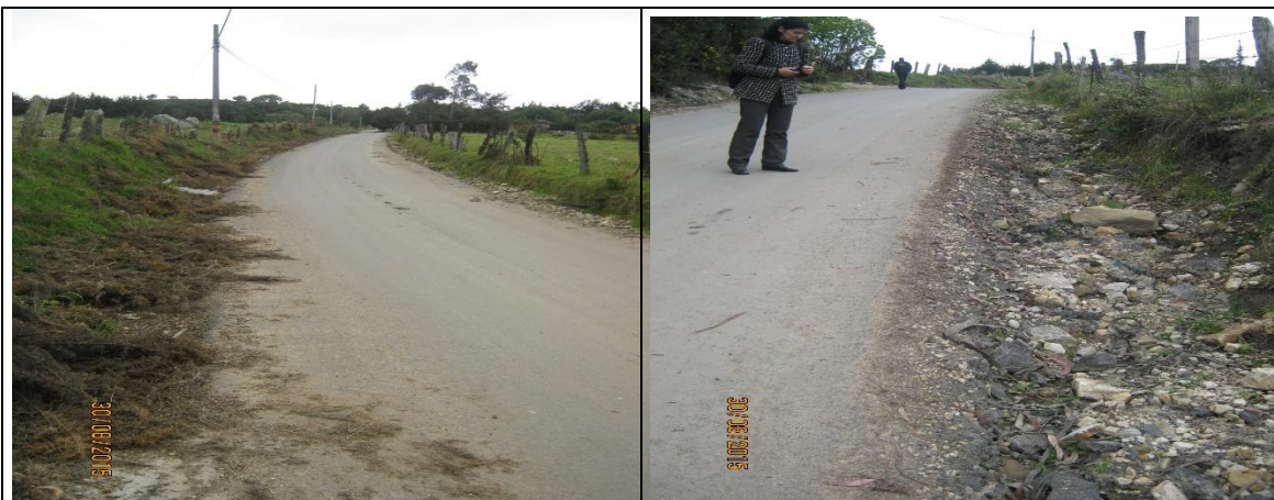
Foto No 12: Se observa la pérdida de agregado en las partes laterales de la vía, ocasionadas por la falta de una estructura de confinamiento (SARDINEL Y/O CUNETETA) que impida que el agregado se suelte, ya sea por el paso de los vehículos, o por la escorrentía superficial generada por las aguas lluvias.
