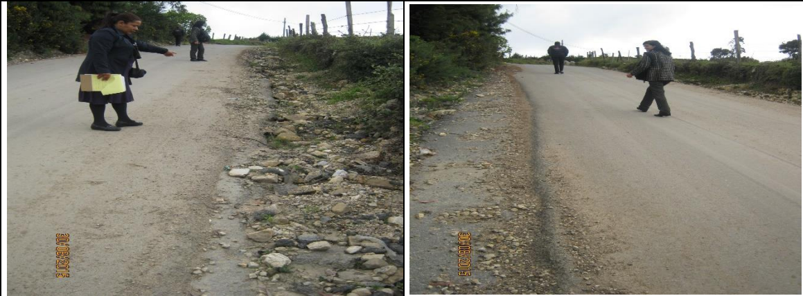
Foto No 13 : Se observa la pérdida de agregado en las partes laterales de la vía, ocasionadas por la falta de una estructura de confinamiento (SARDINEL Y/O CUNETETA) que impida que el agregado se suelte, ya sea por el paso de los vehículos, o por la escorrentía superficial generada por las aguas lluvias.
