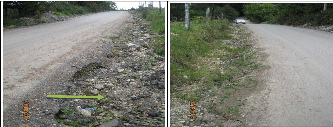
Foto No 11: Se observa la pérdida de agregado en las partes laterales de la vía, ocasionadas por la falta de una estructura de confinamiento (SARDINEL Y/O CUNETETA) que impida que el agregado se suelte, ya sea por el paso de los vehículos, o por la escorrentía superficial generada por las aguas lluvias.
