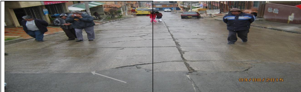
Foto No 5. Se observa que la intervención del segmento vial, presenta una inadecuada terminación.
